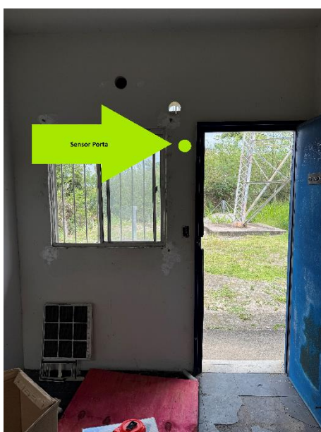
Posição TX, QDG, sensor e trafo 2
