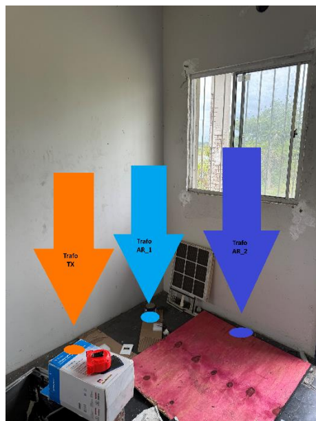
Posição TX, QDG, sensor e trafo 1
