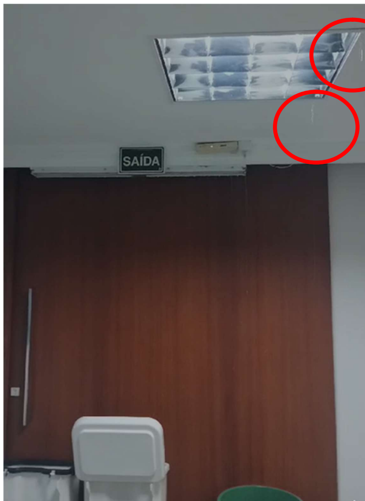
Figura 3 - Vazamentos no teto
