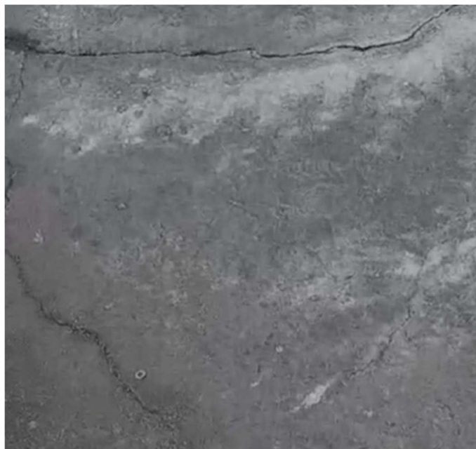
Figura 2- Trincas no teto
