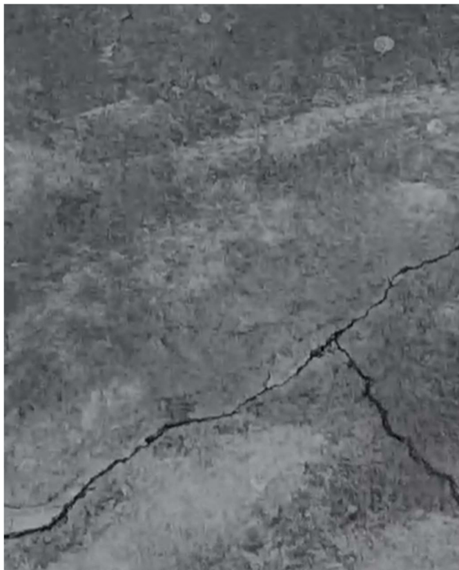
Figura 1- Trincas no teto
