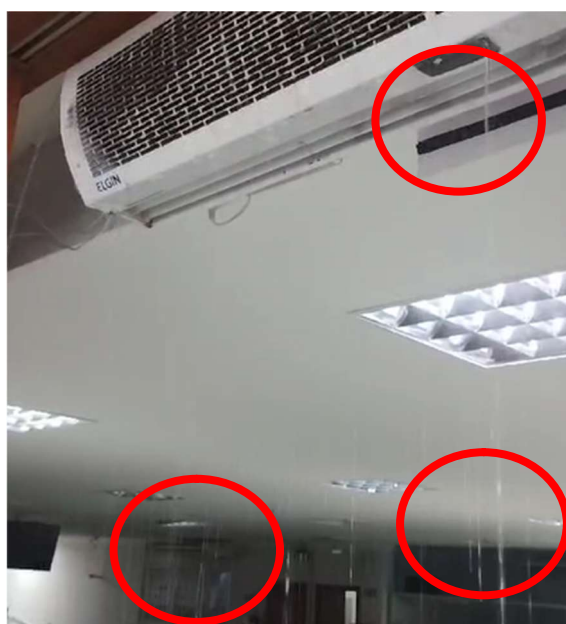
Figura 4 - Vazamentos no teto
